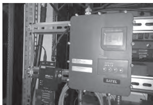
Fot. 2. Radiomodem komunikacyjny UHF stacji BT Elbląg
